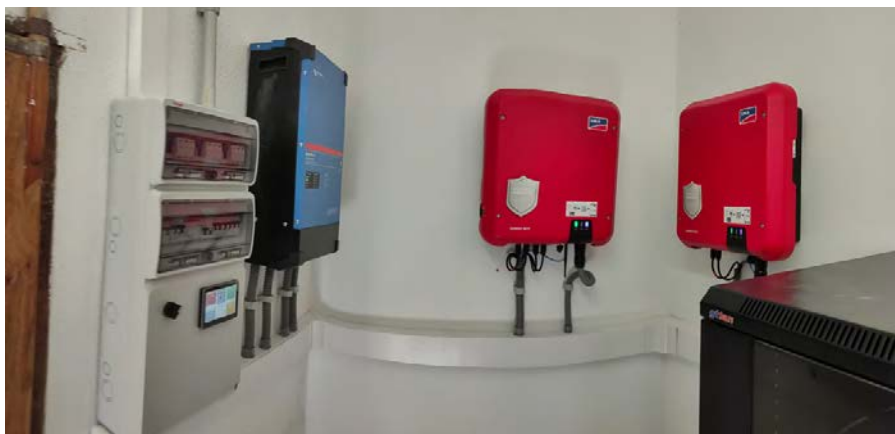
Instalación de autoconsumo en una vivienda unifamiliar en núcleo urbano en el municipio de Altea (Alicante) realizada por Instalaciones Antelec
