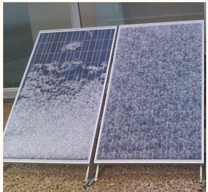
Figura 2. Nieve depositada sobre módulos fotovoltaicos (Foto cortesía de Lurederra). / Figure 2. Snow deposited on photovoltaic modules (Photo courtesy of Lurederra).
