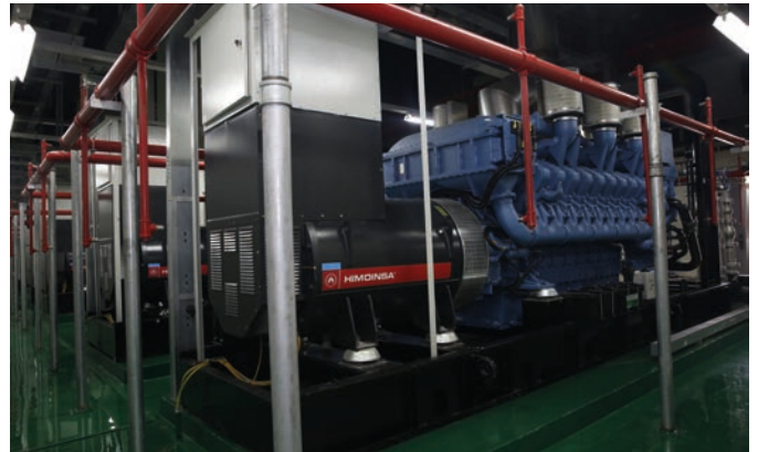
Proyecto de 24 MW en el Data Center del grupo Alibaba en China.
