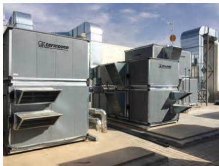
Climatizadoras aire y agua.
