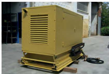
Grupo electrógeno con sistema de rail extraíble para facilitar el mantenimiento
