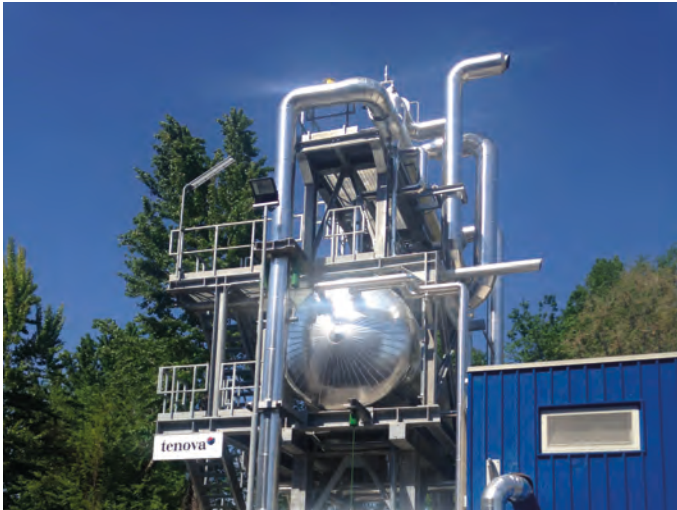
Sistema de generación de calor para la red de distrito de la ciudad de Brescia. Fuente: ORI MARTIN
