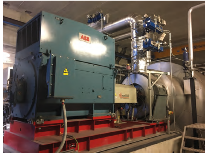
Sistema ORC y turbogenerador instalado en ORI MARTIN. Fuente: Ori Martin
