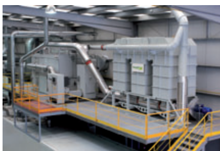
Equipo de tratamiento de COV's.
