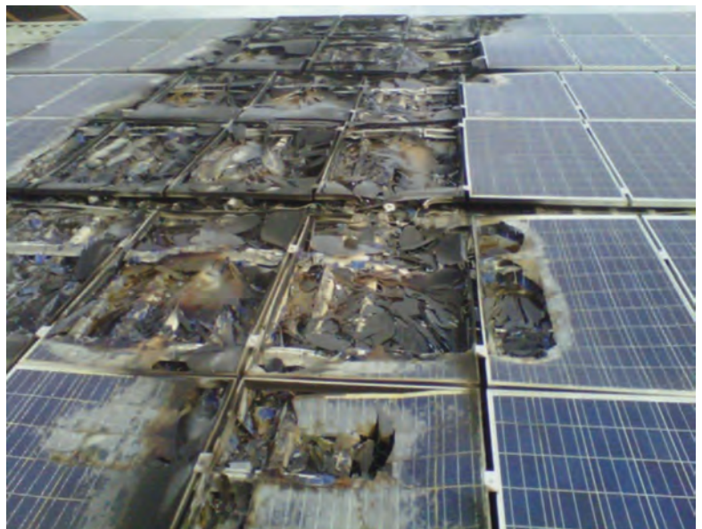
Imagen 10: Incendio en una planta fotovoltaica (Fuente: TÜV Rheinland).
