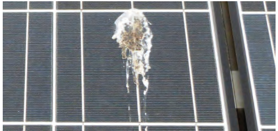
Imagen 6: Excremento de pájaro sobre módulo fotovoltaico (Fuente: Homepower).
