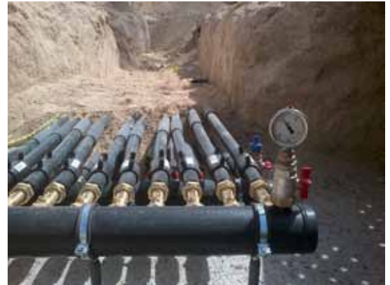
Diseño específico de ingeniería e instalación de colector en campo de conexión.
