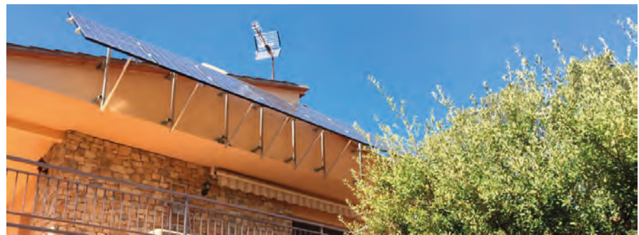
Instalación fotovoltaica sobre la fachada de la vivienda.
