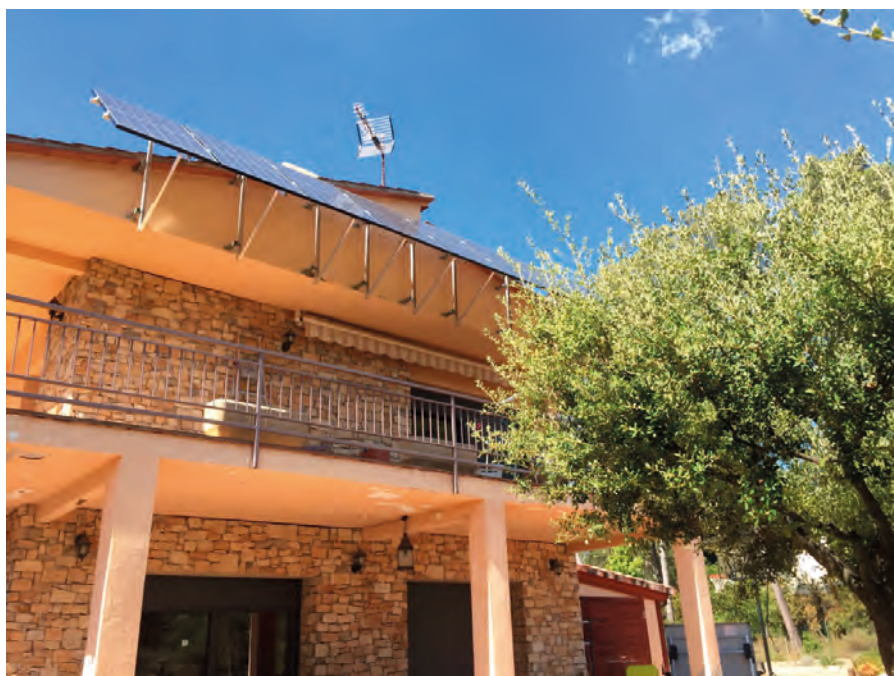
Vista de la vivienda donde se ha realizado la instalación.
