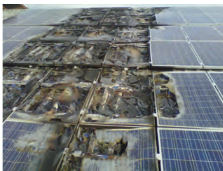
Algunos paneles han de ser reciclados antes de tiempo debido a incidencias inesperadas, como un incendio. Foto: TUV Rheinland.
