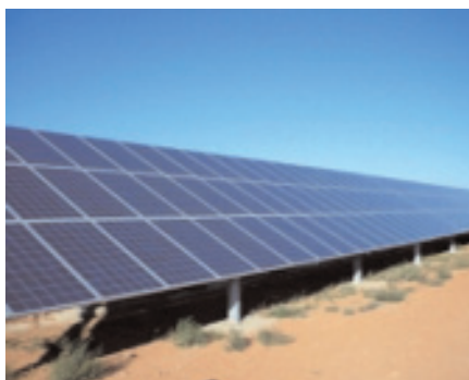
Axitec installed: sistema de 660 kWp realizado en Albacete por Promociones Fotovoltaicas Manchegas, con módulos Axitec, en una superficie de 10.000 m 2 .
