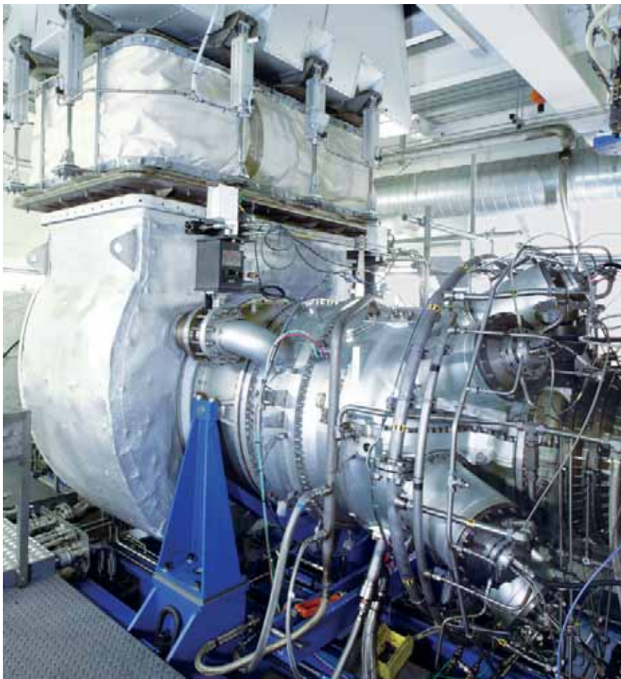
Una turbina de gas SGT-400 de 12,9 MW(e) es el componente clave de una planta de cogeneración de calor y electricidad operada por RWE Npower Cogen, que suministra energía a una instalación donde se produce dióxido de titanio.
